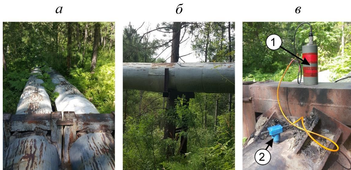
Рис. 1. Жесткое крепление труб к опоре (а); трубы на опоре без жесткого крепления (б); установленные на трубе регистратор 1 и геофон 2 (в).
